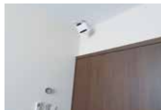
各居室の天井に設置された見守りモニター。
